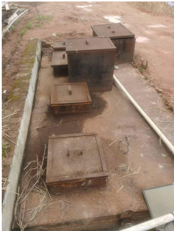
污水处理设施
