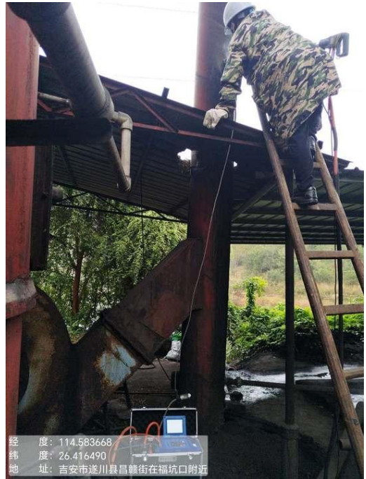
锅炉废气出口
