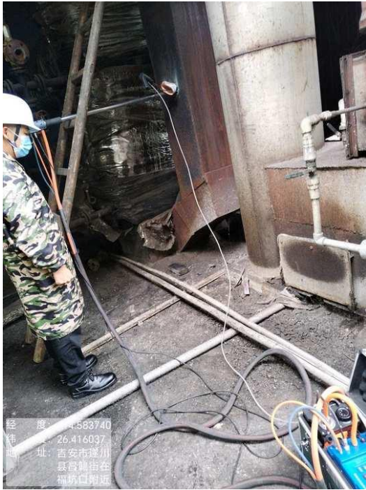
锅炉废气进口
