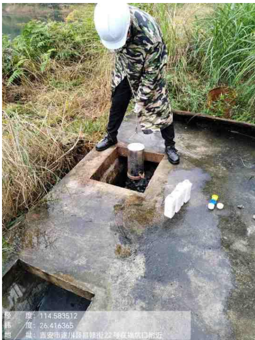
综合废水处理设施进口
